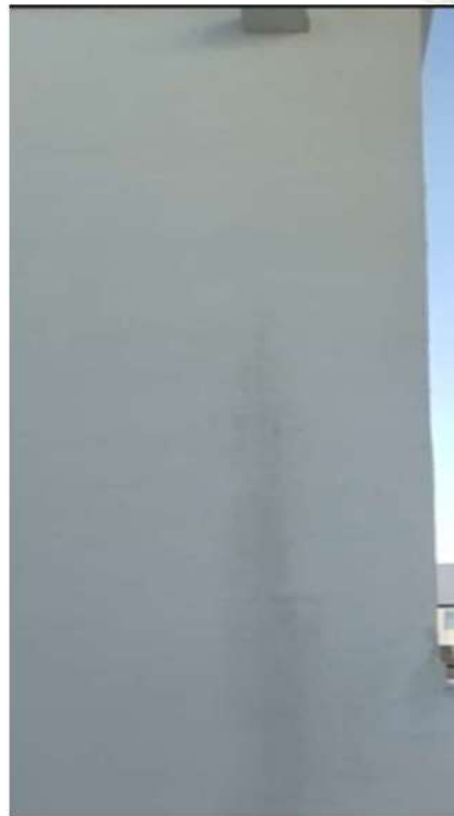
“Mancha por caída de agua Del desagüe lateral”.
