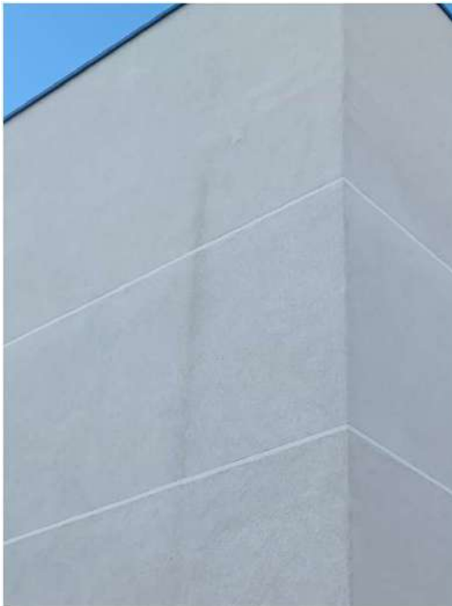
Escorrentía de junta de albardilla
